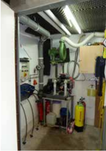
Vorher: Der Kompressor im Bootsdeck.
