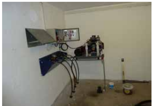
Nachher: Der Kompressor in der Garage.
